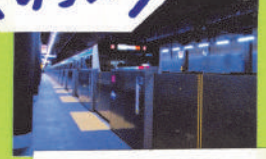
ホームドアの設置 相鉄では、2022年度中に全駅にホームドアを設置する予定。
