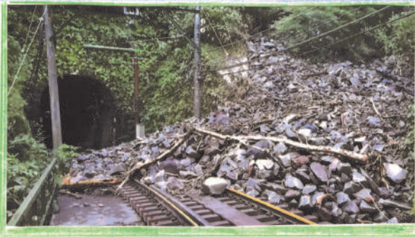
被災した蛇骨陸橋
