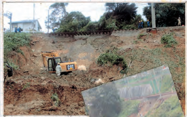
24日の夜中に花山駅〜大池駅間の法面が崩れていて、崩れた所の大きさは横20m、高さ15mです。線路下の土も流れ出し、電車が浮いた状態でした。
