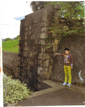
昭和初期の小川を渡るための鉄橋の橋台が現在も残っている。
