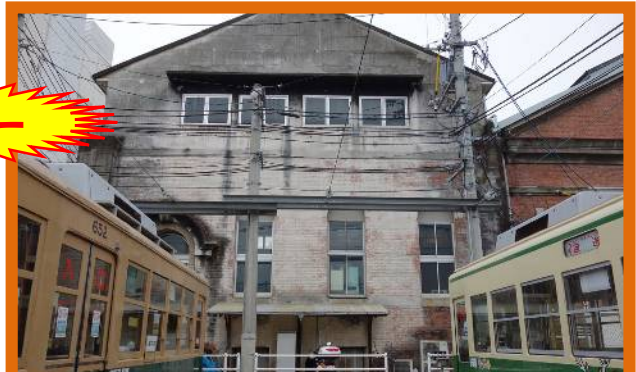
被爆した変電所。奇跡的に倒壊を免れたコロ！
