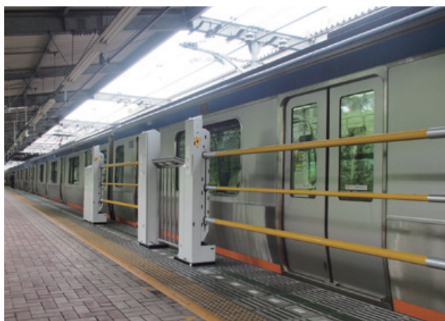
相模鉄道いずみ野線弥生台駅に設置された昇降バー式ホームドア。列車運行への影響や安全性、バーの昇降速度や機能面について検証を行う。
