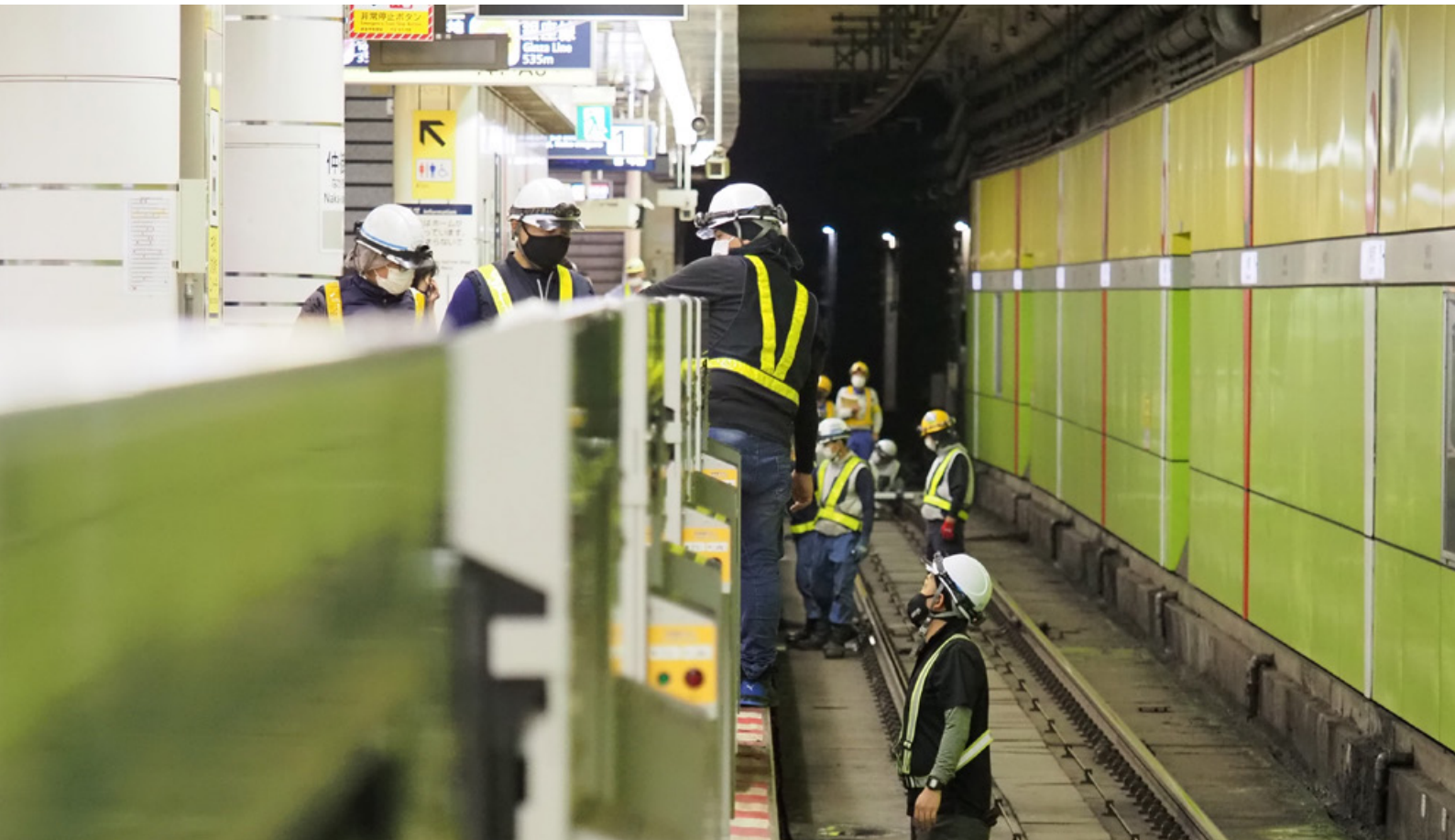
ホームドアの設置工事。ホーム下からホームドアの固定を開始する
