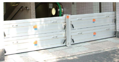
駅出入口の止水板
