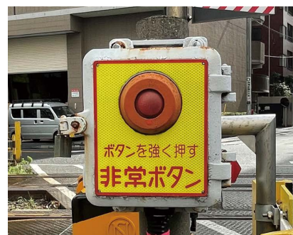
支障報知装置(非常ボタン)
