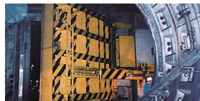
トンネル内の防水ゲート
