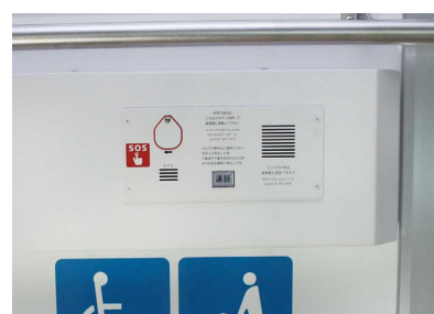
非常通報装置
