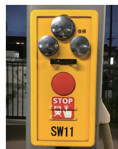
非常停止押しボタン
