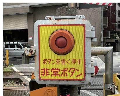
支障報知装置(非常ボタン)
