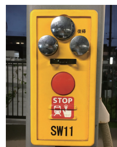
非常停止押しボタン
