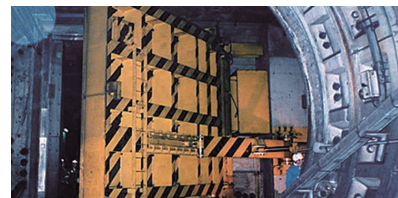
トンネル内の防水ゲート
