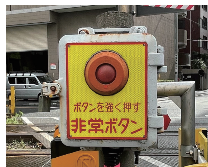
支障報知装置(非常ボタン)
