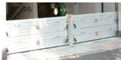
駅出入口の止水板
