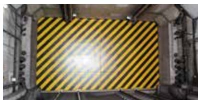
トンネルの断面を閉鎖する防水ゲート
