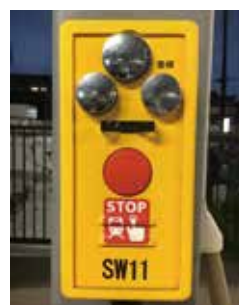
非常停止押しボタン
