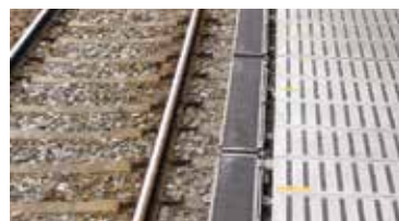
転落検知装置
