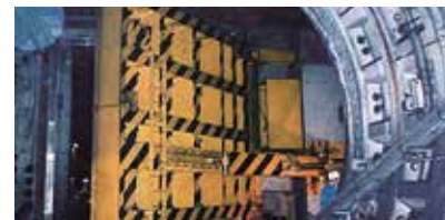
トンネル内の防水ゲート
