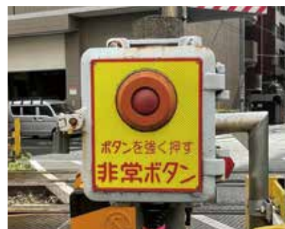
支障報知装置(非常ボタン)
