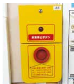
非常停止押しボタン
