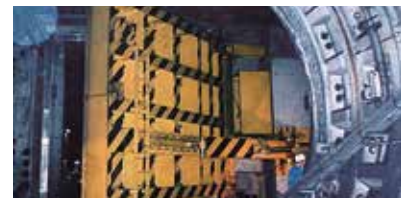
トンネル内の防水ゲート
