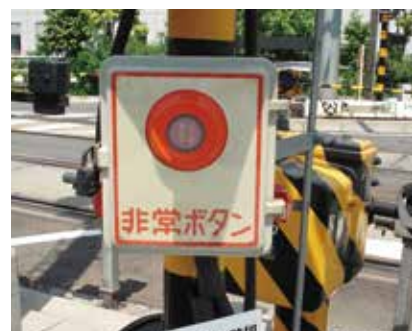
支障報知装置(非常ボタン)
