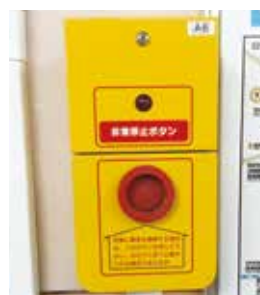
非常停止押しボタン
