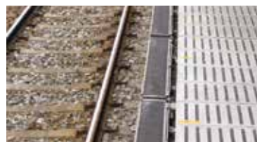
転落検知装置
