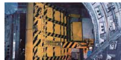
トンネル内の防水ゲート
