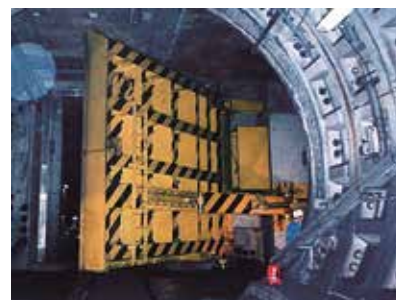
トンネル内の防水ゲート
