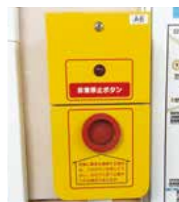
非常停止押しボタン
