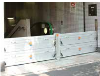
駅出入口の止水板
