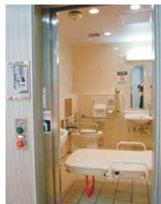
移動制約者用トイレ(個室)
