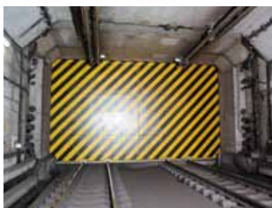
トンネルの断面を閉鎖する防水ゲート
