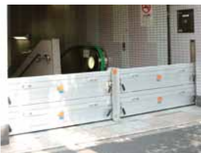
駅出入口の止水板
