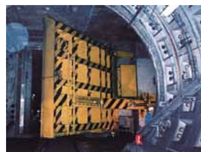
トンネル内の防水ゲート
